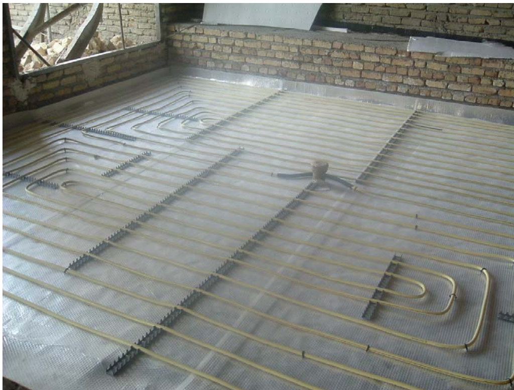
نمونه اجرای سیستم گرمایش کفی در محیط‌های دور استخر
