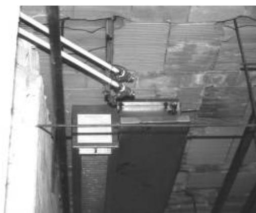
نمونه لوله کشی فن کویل های سقف
