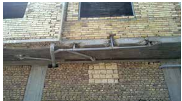
عبور لوله‌های تاسیسات از داخل تیرهای بتنی
